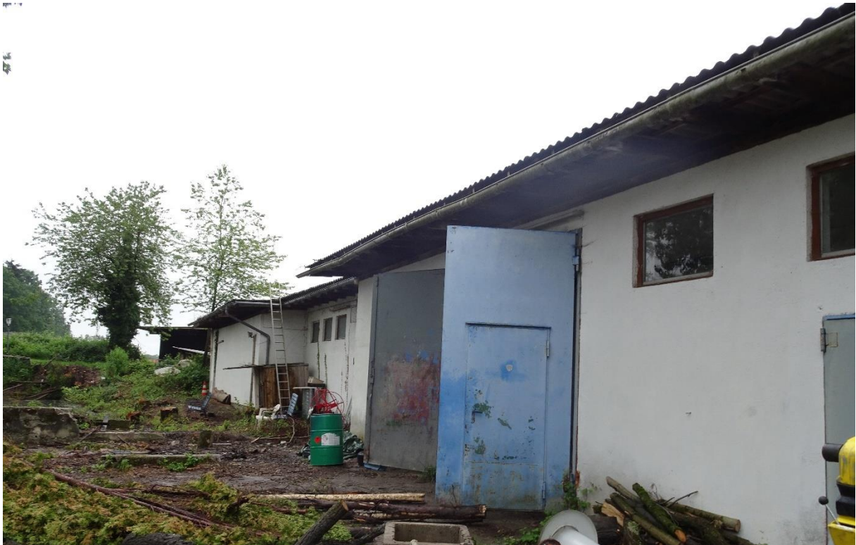
Abbildung 7: Lager- bzw. Werkstatthalle südlich des großen Teichs mit einfacher Dachkonstruktion. Blick Richtung Osten.
